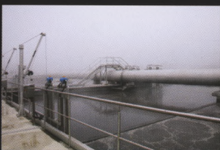
Oczyszczalnia Ścieków „Czajka”, reaktor biologiczny
