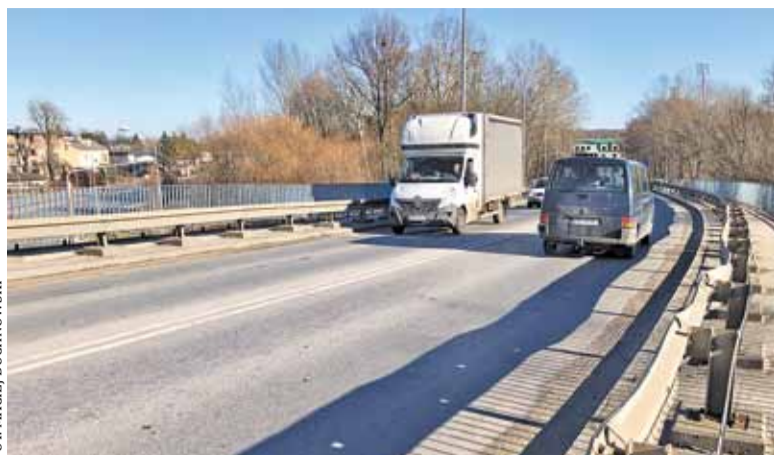
Wiadukt czeka na remont
