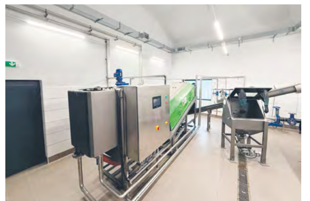
Oczyszczalnia ścieków w Pawłowicach
