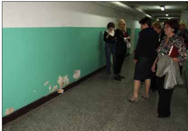
Zagrzybione ściany w dolnej części gimnazjum
