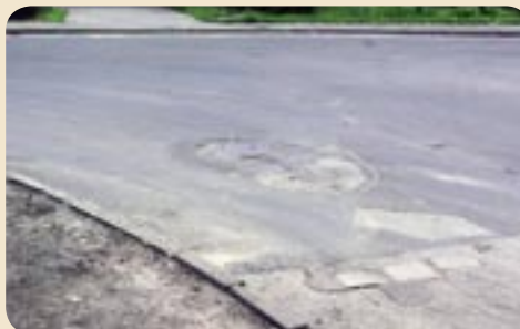
Wymagająca naprawy studzienka na Bolkowskiej
