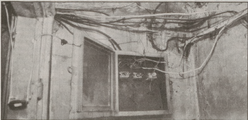
Taka instalacja elektryczna zdecydowanie nie nadaje się do użytku.
