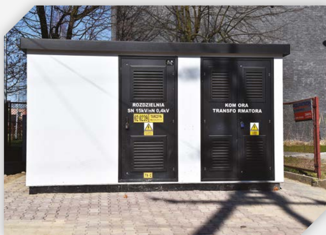
Nowa, kontenerowa stacja TRAFO
