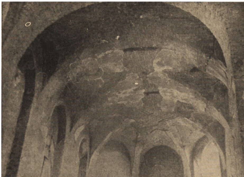
Ryc. 247. Sklepienie prezbiterium — stan zniszczenia.
