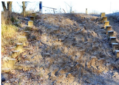
Drewniane stopnie schodów zmieniły właściciela
