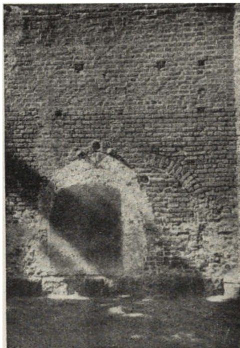
Ryc. 201. Fragment przyziemny ściany północnej wieży przed robotami konserwatorskimi (widoczne jest zamurowanie wejścia pod niszą).
