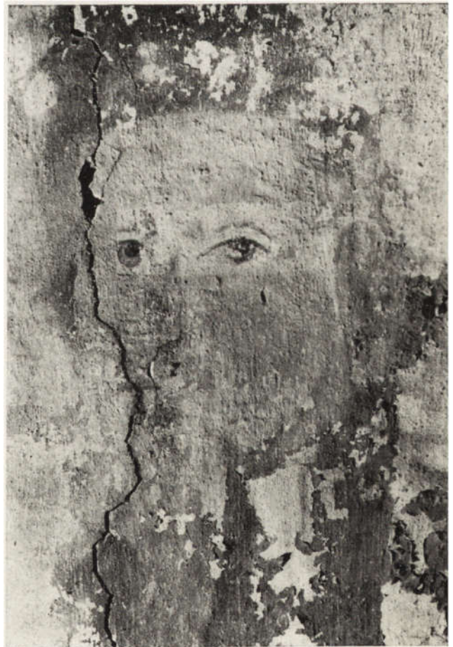
Il. 9. Oliwa. Katedra, południowa ściana prezbiterium, malowidło ściennie, fragment z widoczną łuszczącą się warstwą malarską. Przed konserwacją
