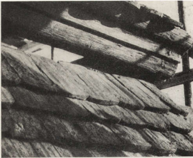
2. Deska okapowa w miejscu zatamania dachu mansardowego, połaci zachodnia. Jedyne zachowane pierwotny element architektoniczny opracowany dekoracyjnie (fot. P. Gartkiewicz)
