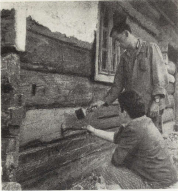
2. Sanok, Muzeum Budownictwa Ludowego, impregnacja Xylamitem Popularnym konstrukcji chałupy z Dąbrówki (fot. W. Szulc)
