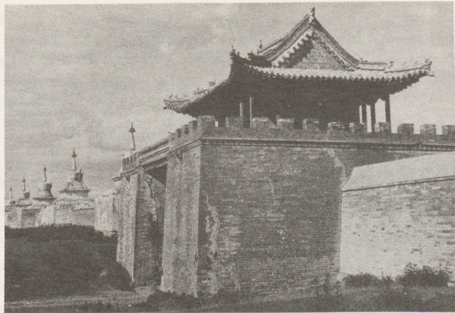
3. Jedna z bram klasztoru, widoczne uszkodzenia
