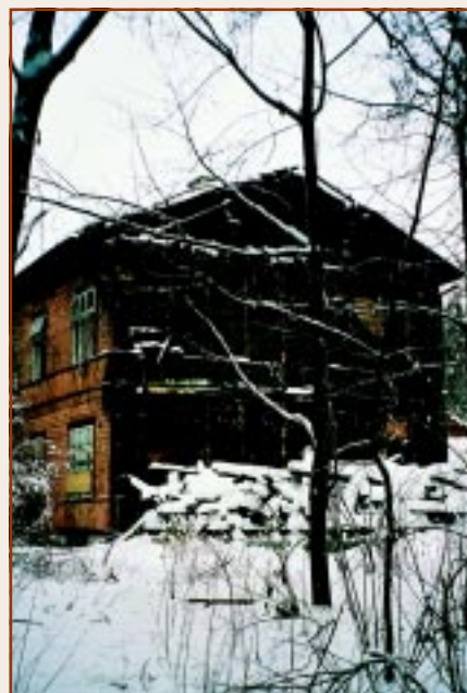
Ślady pożaru z prawej strony budynku
