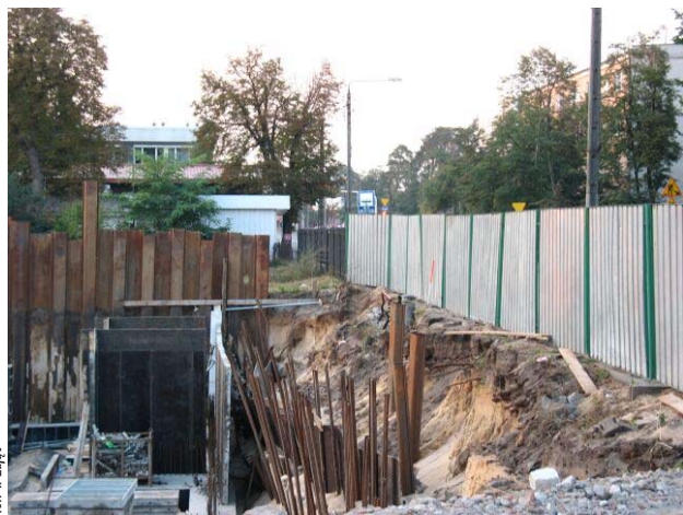
Awaria ścianki szczelnej w wykopie przy ul. Andriollego
