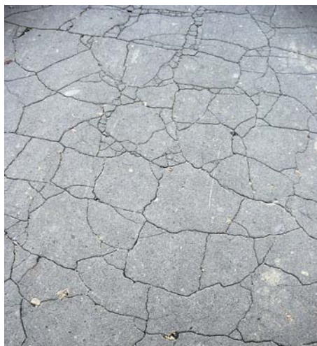
Siatka spękań zmęczeniowych na ul. Narutowicza
