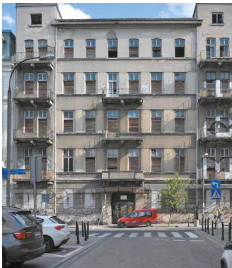
W latach 90. XX w. budynek popadł w ruinę
