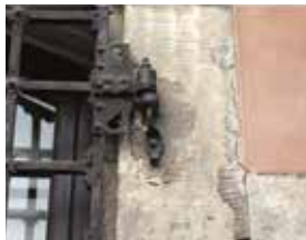
Detal kamienny i metaloplastyka, stan przed renowacją
