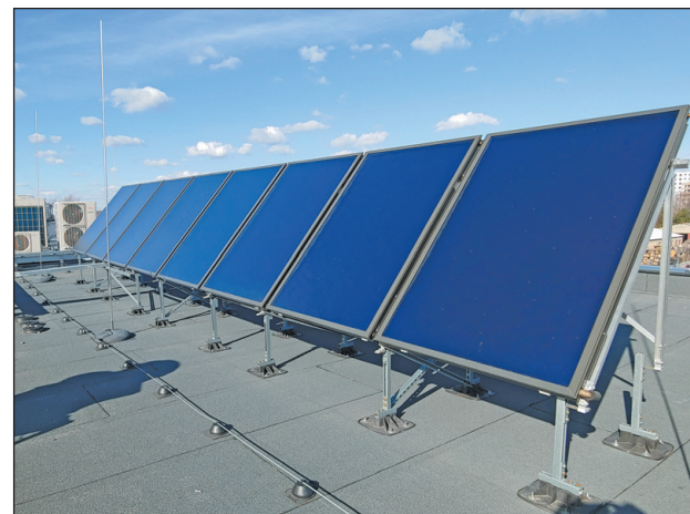
Panele słoneczne na dachu budynku CEM w Piasecznie
