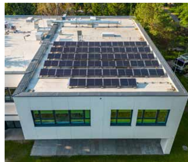
Panele na dachu Przedszkola nr 346, fot. S. Korzeniewski
