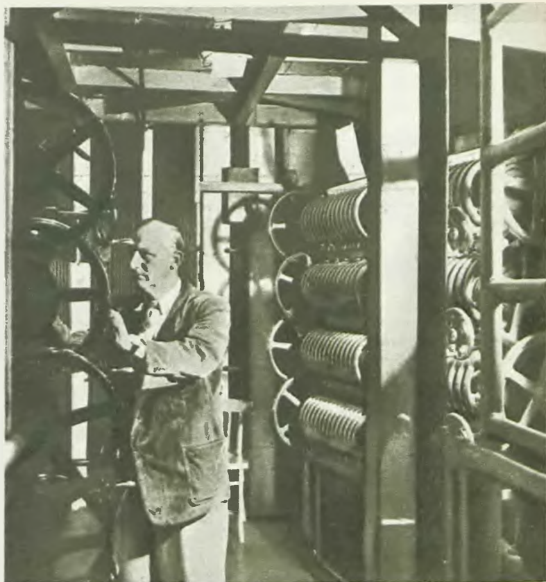
Kabina elektryka sceny rozporządza 160-oma obwodami nastawni
